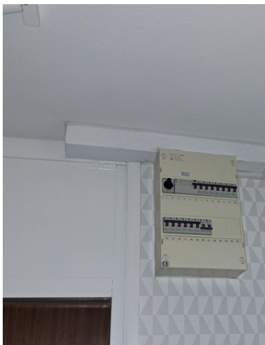
Bild 3. VVC-ledning inbyggd i hall i bostad.
