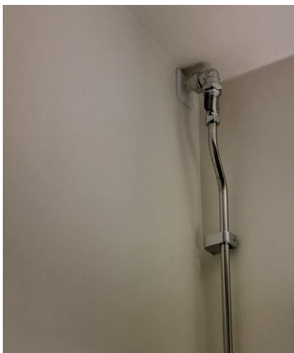
Bild 2. VVC-ledning i badrum.
