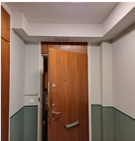
Bild 1. Färdigt utseende i trapphus. Ledningarna ligger bakom den gipsade lådan i taket.
